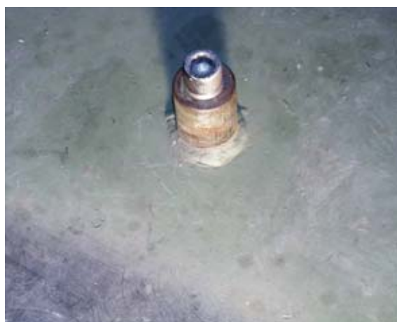
Rys.2 Mocowanie do dachu uległo pęknięciom na spoinie Fig. 2 Joint with roof cracked weld
